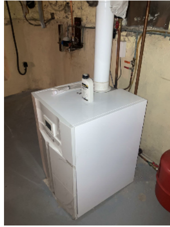
Chaudière gaz récente
