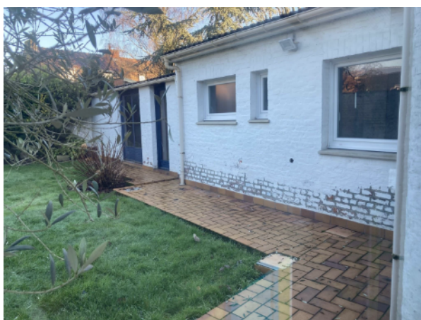
Extension (WC et SdB) et dépendances Murs en brique de terre cuite et toiture en tuile de terre cuite traces de remontées capillaires sur les murs. Joints des briques en bon état
