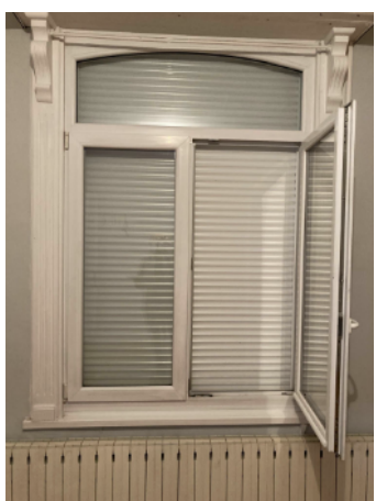
Menuiseries PVC récentes en double vitrage 4/18/4 et volet roulant PVC (côté rue) Coffre de volet roulant ancien en bois non isolé et non étanche à l'air
