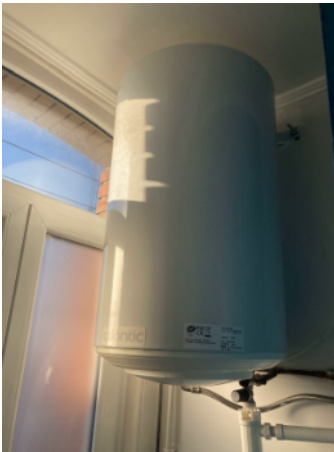
Ballon d'ECS électrique récent de 200 L
