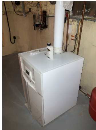
Chaudière gaz au sol hors volume chauffée Réseau de distribution non calorifugé
